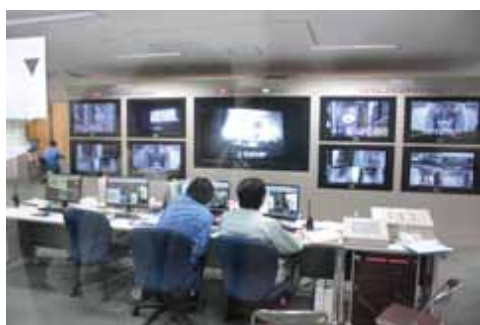
見学者側からの中央制御室の検証
