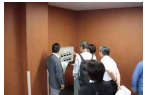
配電盤の検証
